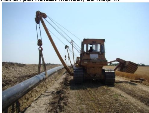
Figură 31 Coloană de lansatoare de țevă în acțiune
